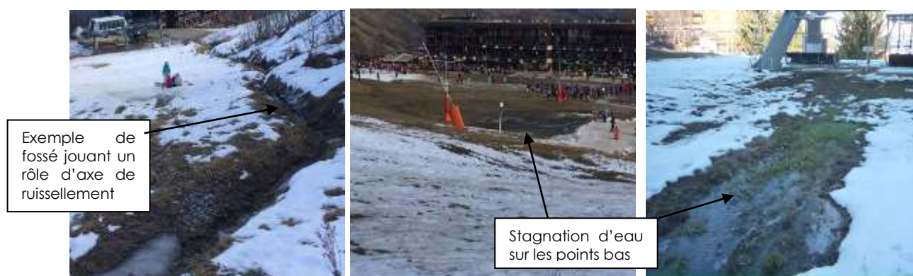
Figure 18 : Traces d'écoulements et de stagnation d'eau
